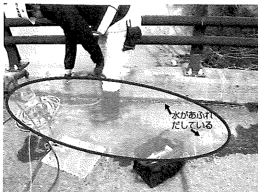
写真-16 損傷の連続性に関する状況写真
